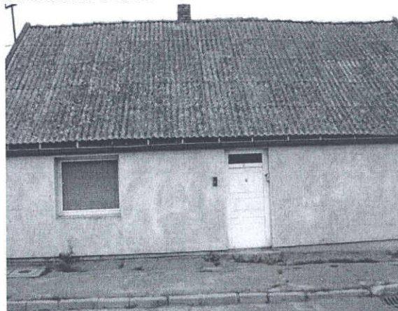
Rys. 7. Pokrycie dachowe ocenione w II stopniu pilności.
