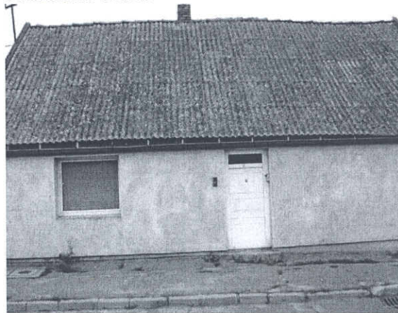
Rys. 7. Pokrycie dachowe ocenione w II stopniu pilności.
