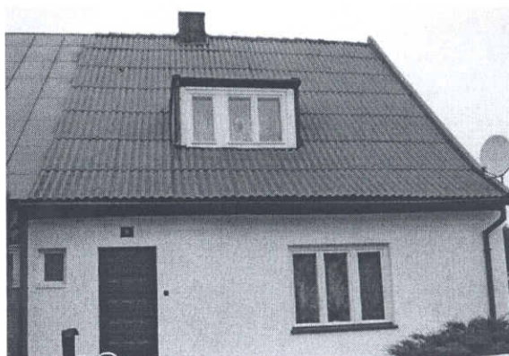
Rys. 6. Pokrycie dachowe ocenione w III stopniu pilności.
