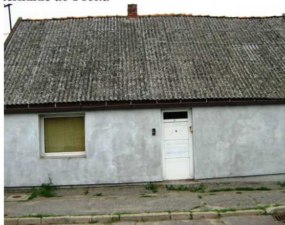
Rys. 7. Pokrycie dachowe ocenione w II stopniu pilności.
