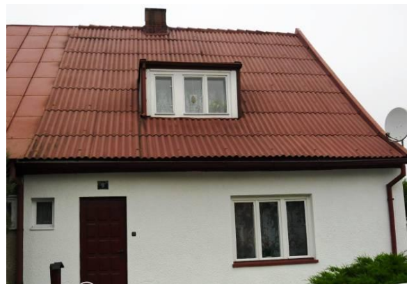
Rys. 6. Pokrycie dachowe ocenione w III stopniu pilności.
