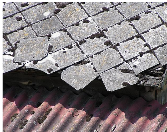
Rys. 8. Pokrycie dachowe ocenione w I stopniu pilności.
